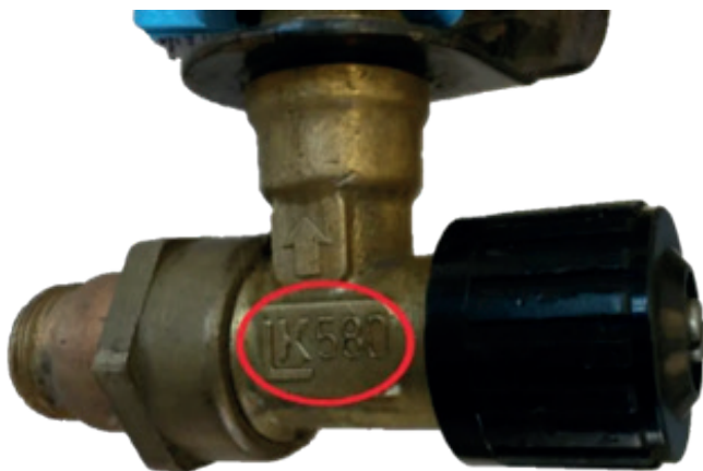
Figur 2: Det finns avstängningsventiler som inte är godkända att använda eftersom de kan orsaka både person- och vattenskador.
